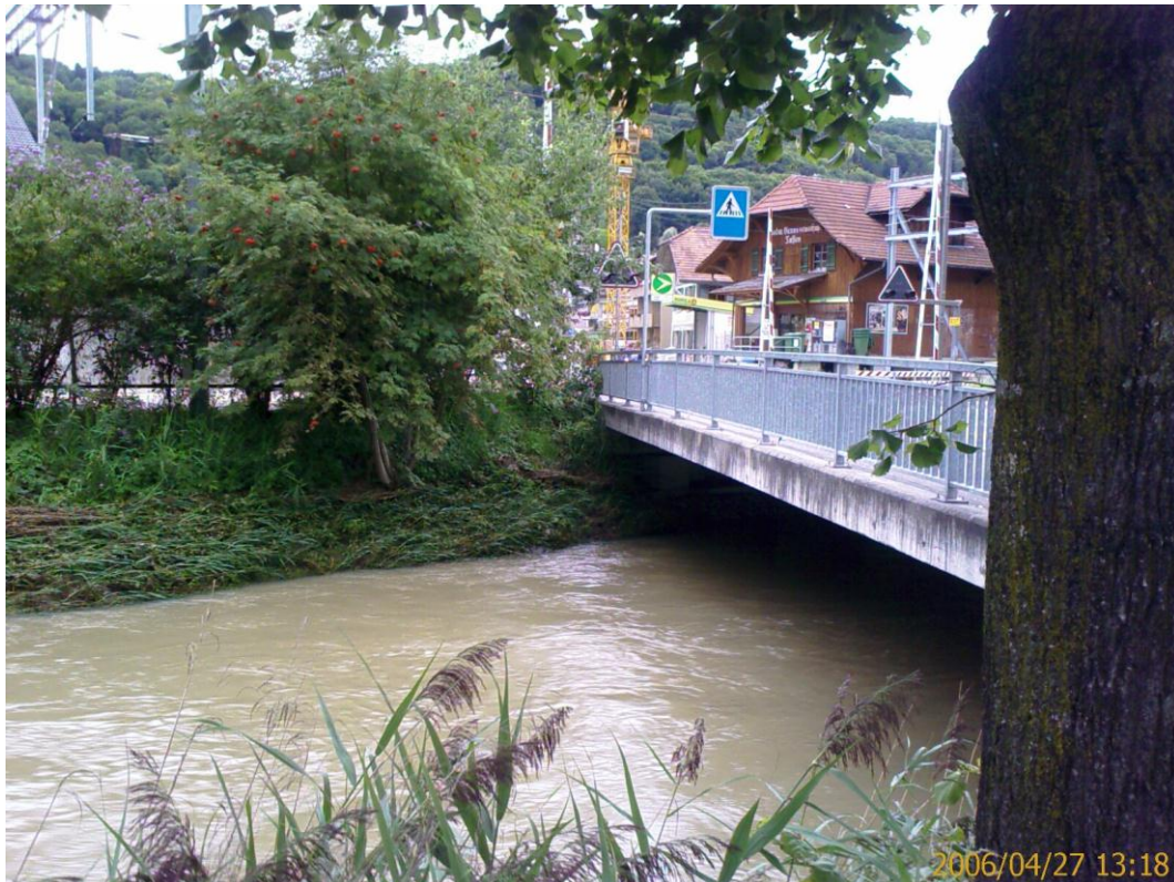
Foto 9: Bahnhofbrücke in Toffen Km 8.750, beim Hochwasser 2005
