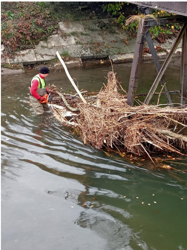
Mittelstütze Brücke oberhalb Belp von Geschwemmsel befreien (November 2024)
