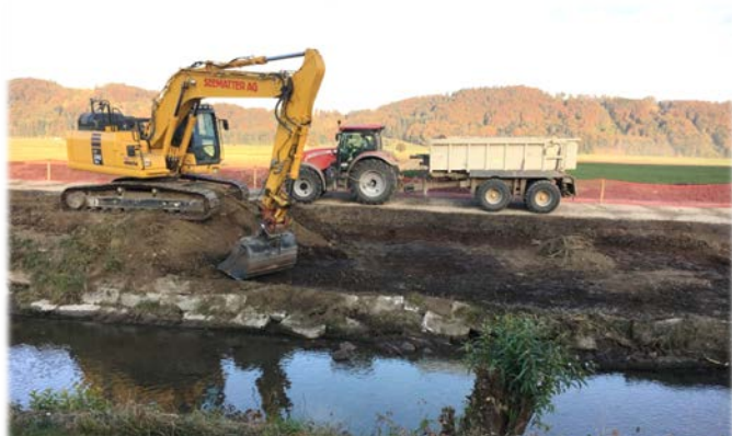
Der Aushub wird ab Baustelle bezogen und in der Nähe für landwirtschaftliche Bodenverbesserung genutzt (23. Oktober 2018)
